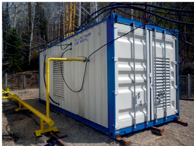
Блочно-модульная станция на объекте
