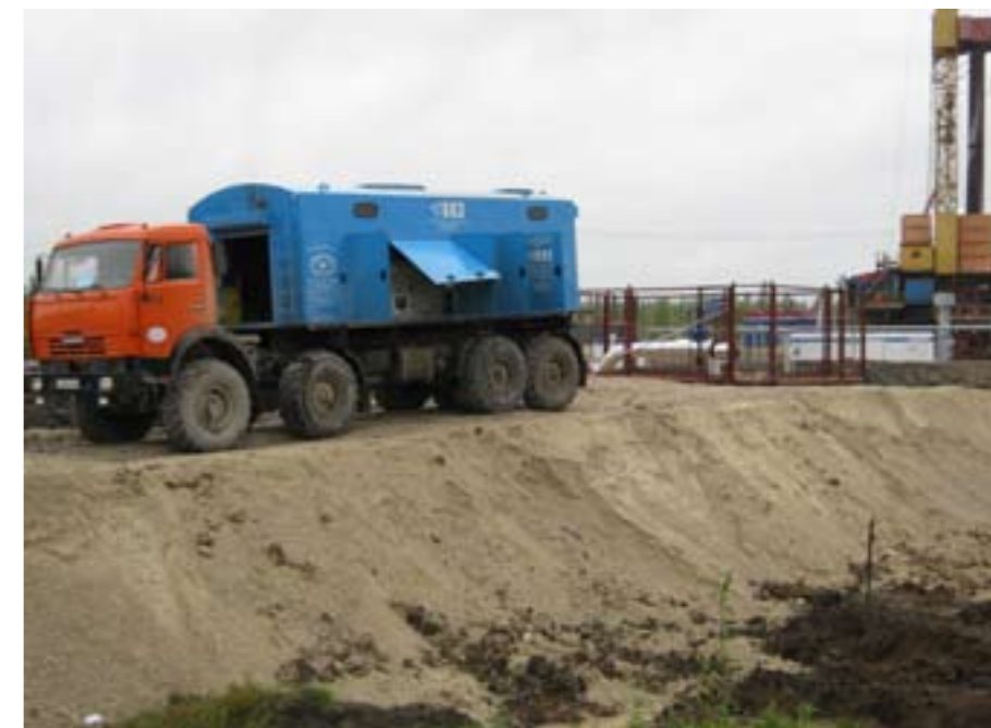
Станция ТГА в работе
