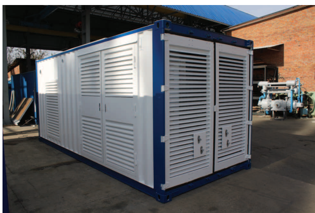
Блочно-модульная азотная станция ТГА
